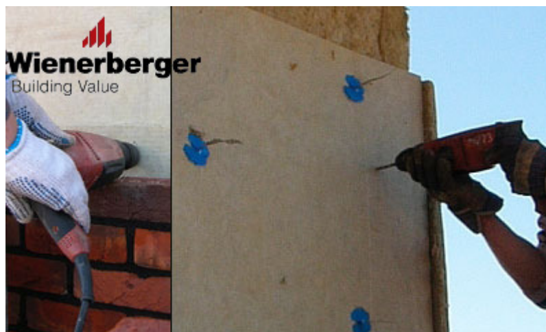
54 pav. Grąžtuvu pragrežiamos vėjo izoliacinė, minkšta šiltinimo plokštė ir keraminių blokų mūras
